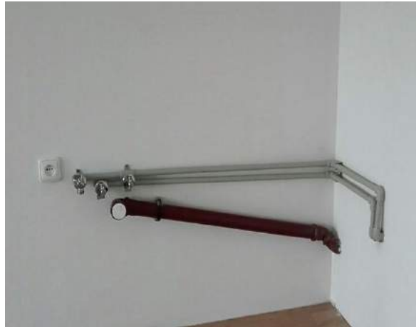
provedení vývodů za kuchyňskou linkou pro dřez a myčku – ve standardu jsou rozvody na povrchu
