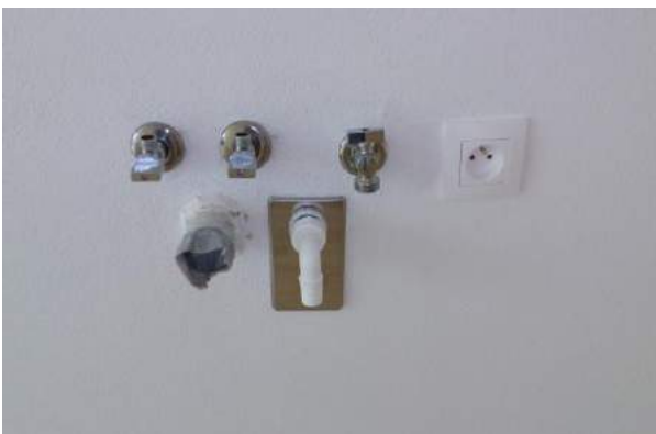
provedení vývodů za kuchyňskou linkou pro dřez a myčku – ve standardu jsou rozvody zasekané pod omítku s výjimkou výše uvedených případů, kde jsou rozvody vedeny na omítce
